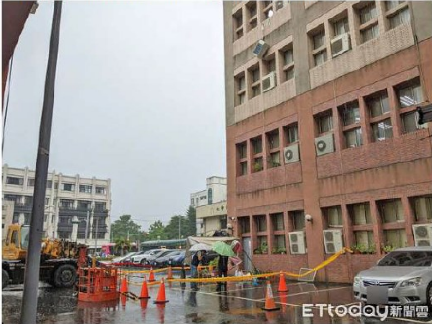
▲雲林縣政府社福大樓發生墜樓意外，冷氣施工人員不慎從4樓墜下身亡，警方封鎖現場蒐證。(圖/記者蔡佩雯翻攝)
