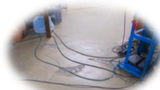
設備電線裸露
